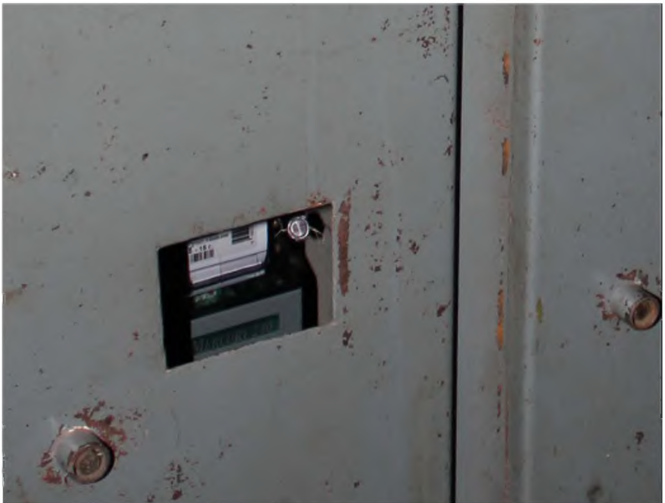
Фото 2.10 Узел учета электроэнергии
