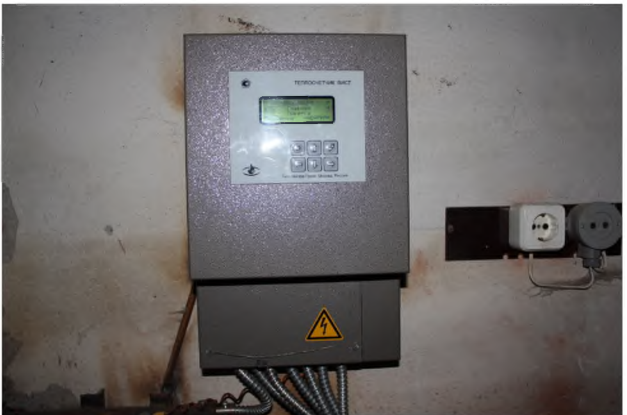
Фото 3.10 Счетчик узла учета системы теплоснабжения
