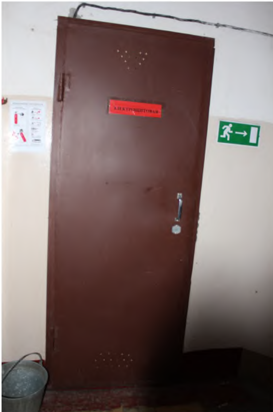
Фото 2.1 Входная дверь в электрощитовую
