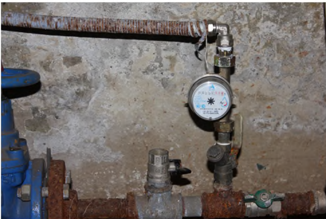
Фото 4.2 Состояние узла учета водоснабжения
