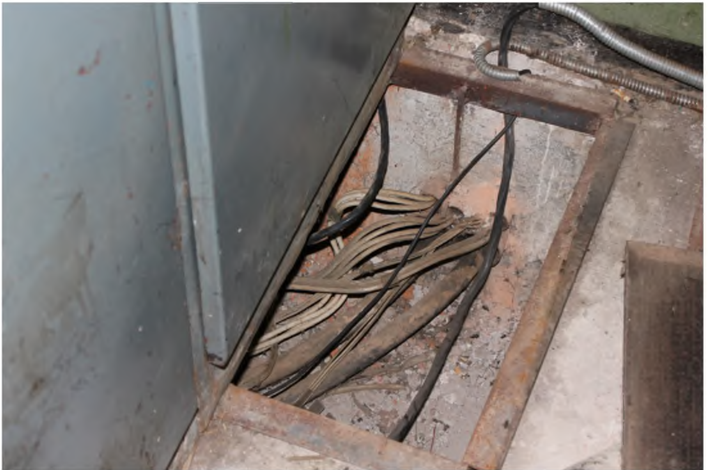
Фото 2.7 Вводные шины подачи электроэнергии в здание
