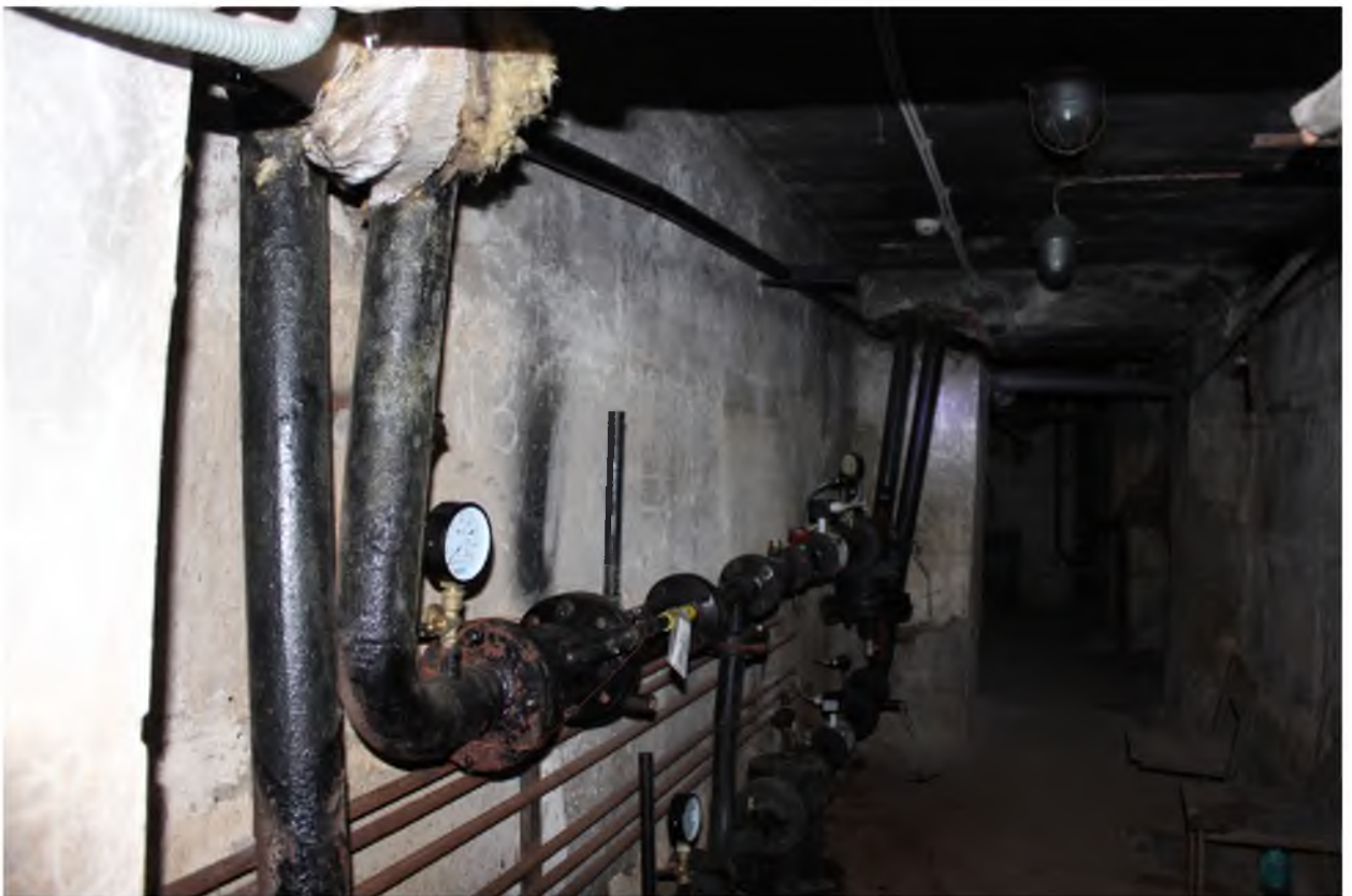
Фото 3.2 Общий вид теплового пункта
