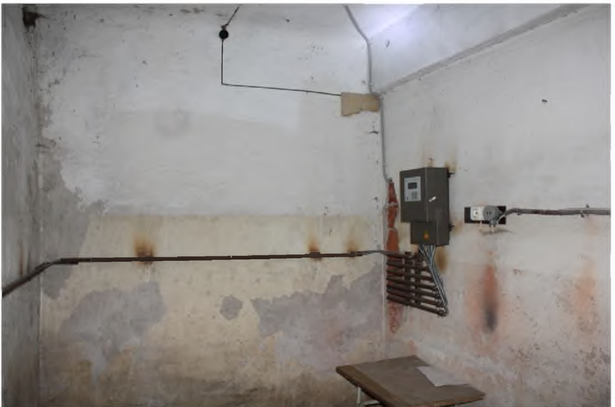
Фото 3.8 Узел учета системы теплоснабжения
