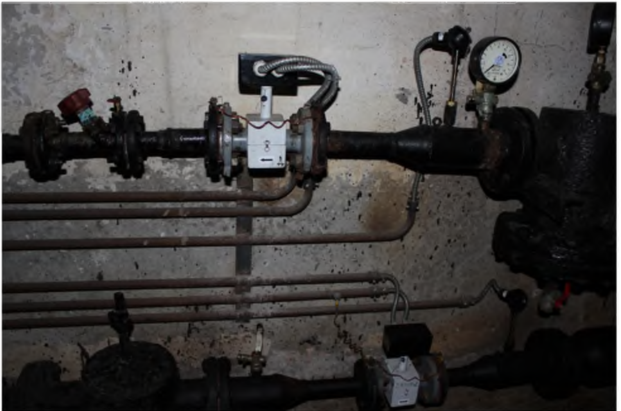
Фото 3.7 Датчики узла учета системы теплоснабжения
