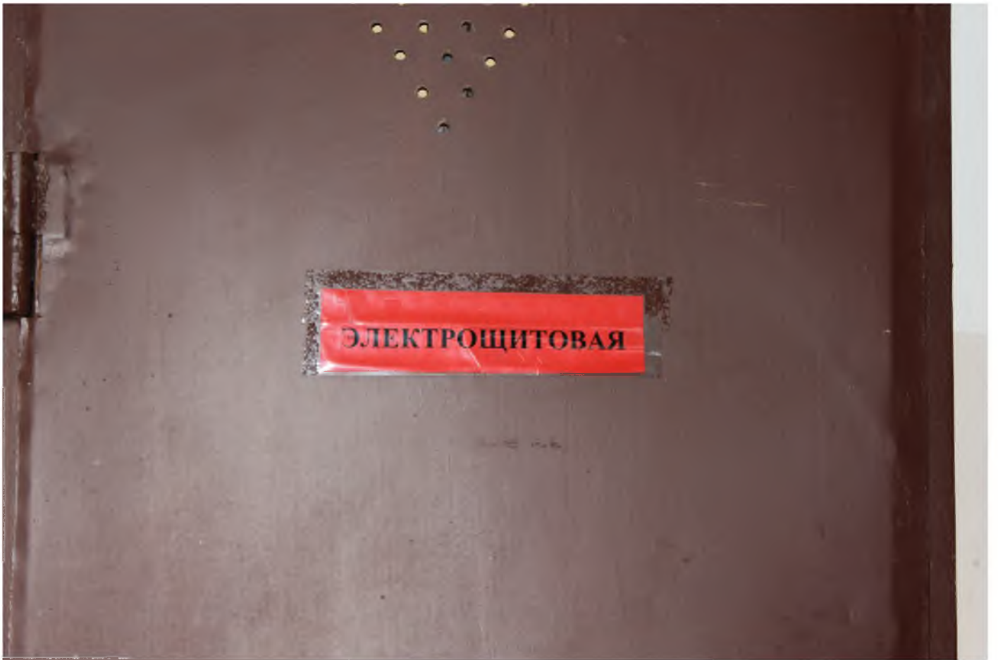
Фото 2.2 Входная дверь в электрощитовую.
