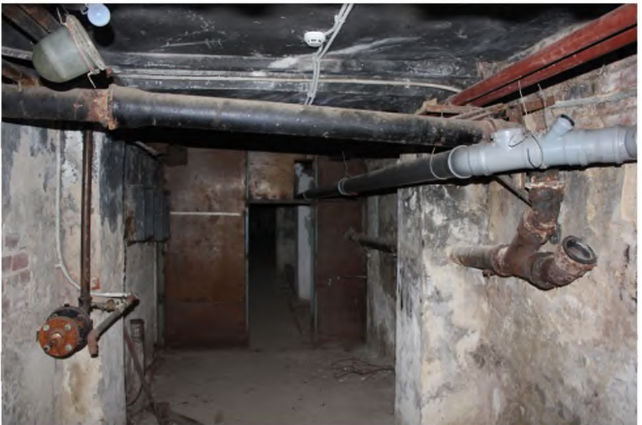
Фото 4.6 Общий вид инженерных коммуникаций в подвале
