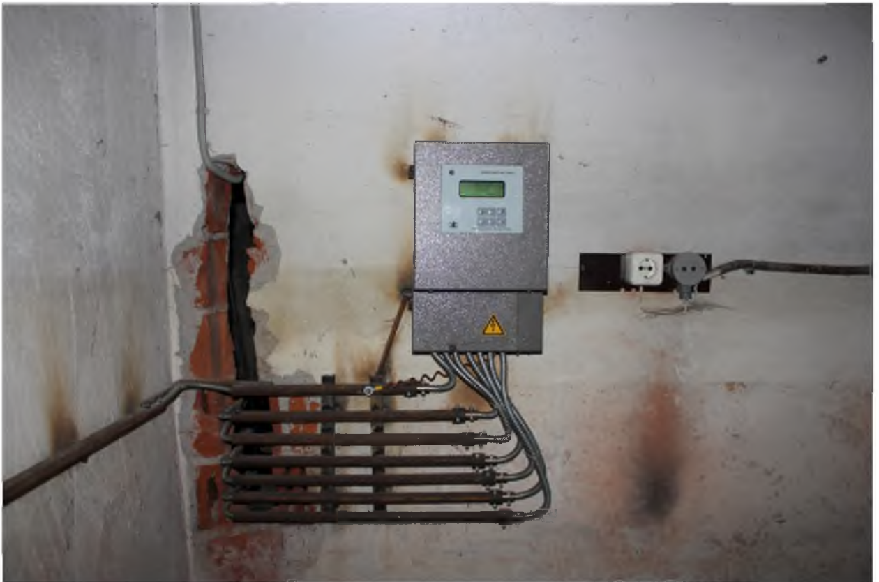
Фото 3.9 Узел учета системы теплоснабжения
