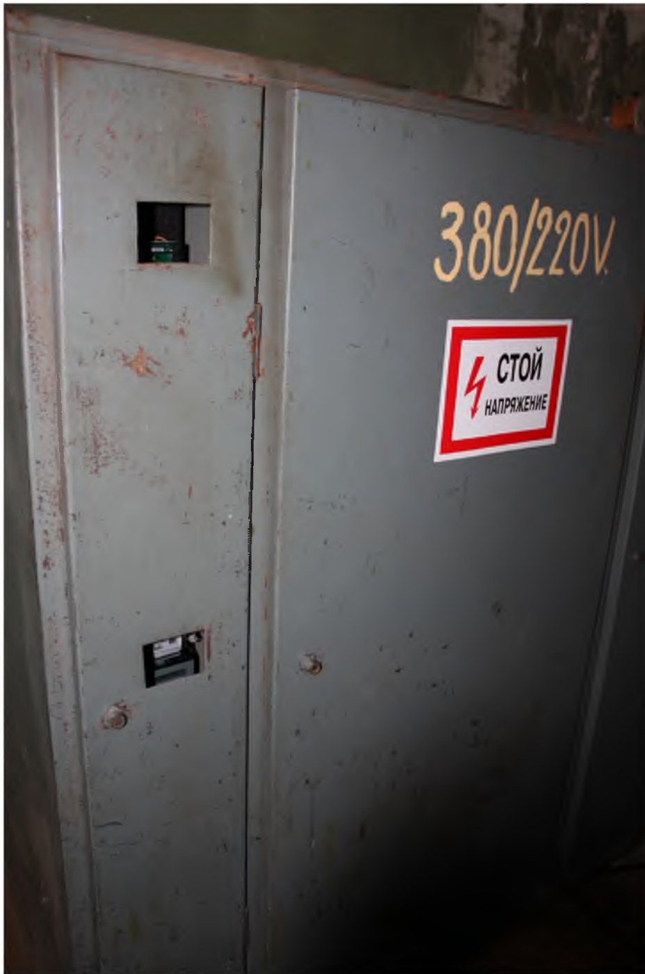
Фото 2.3 Шкафы ввода электроэнергии
