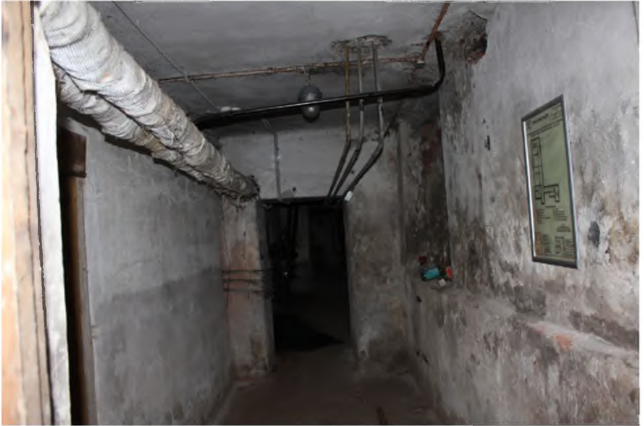
Фото 3.1 Трубы подачи теплоснабжения
