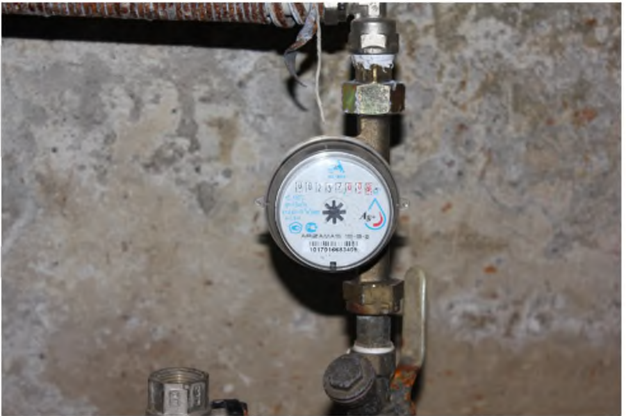
Фото 4.3 Счетчик узла учета водоснабжения
