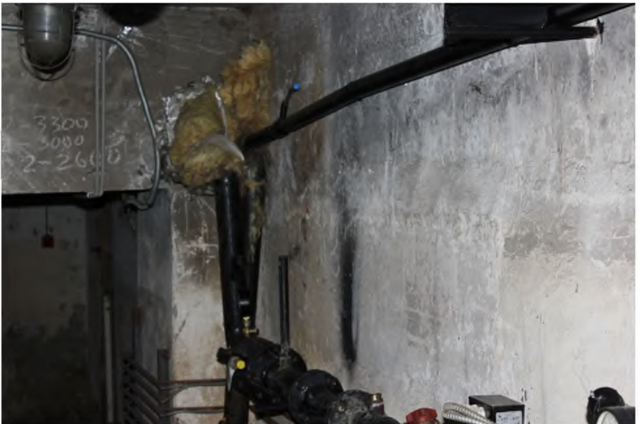
Фото 3.4 Вход труб теплоснабжения в тепловой пункт
