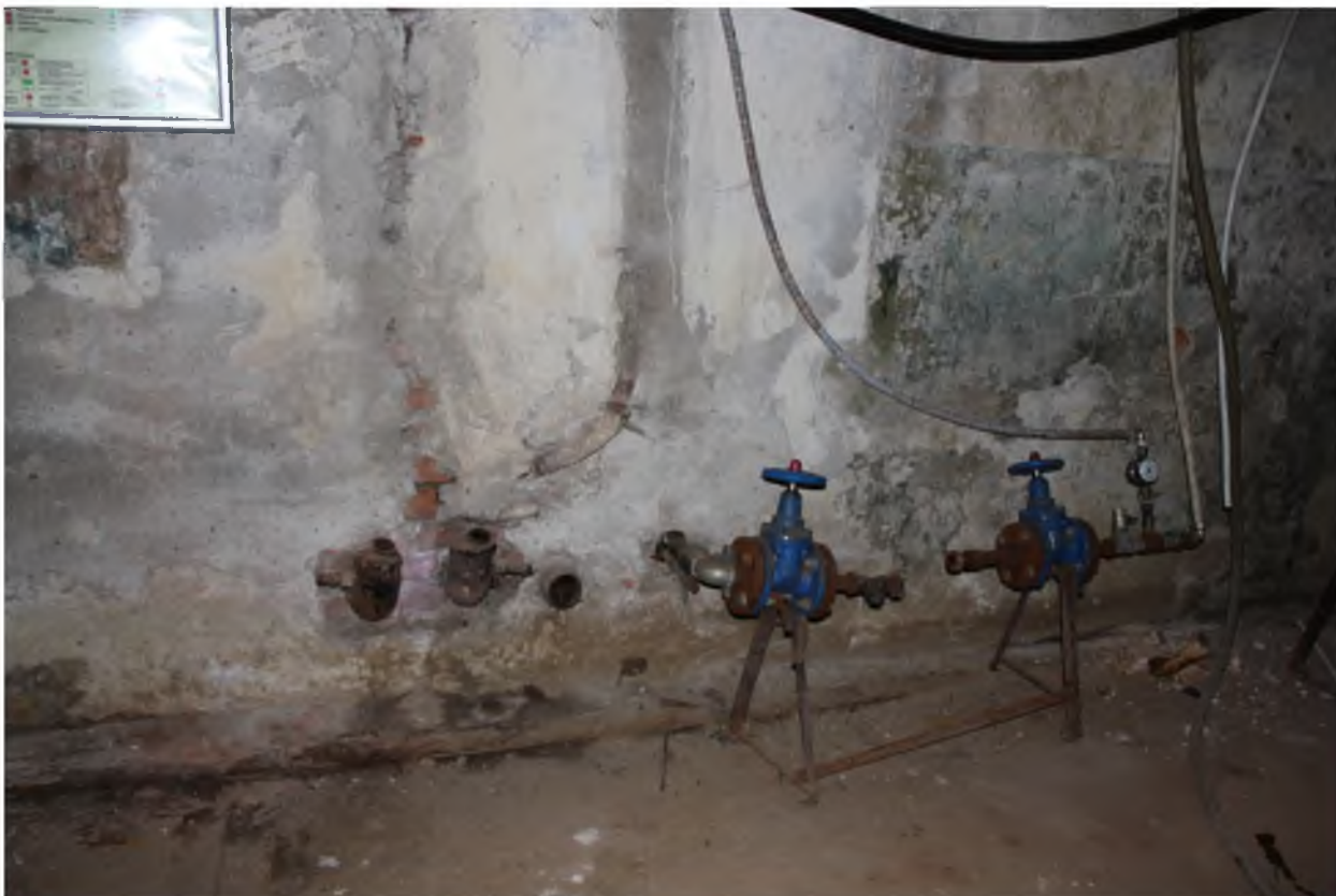
Фото 4. 1 Подача водоснабжения отключена
