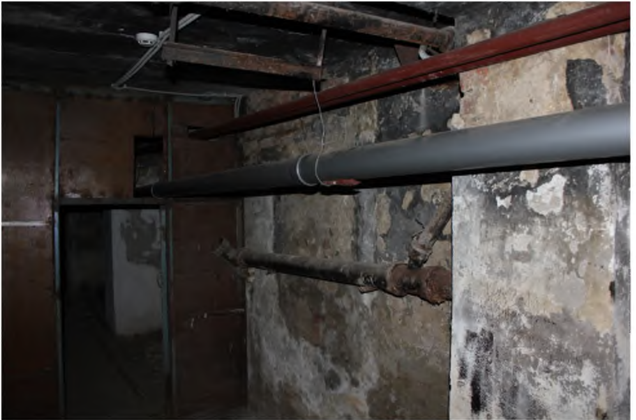
Фото 4.7 Трубы водоотведения. Канализация и водосток
