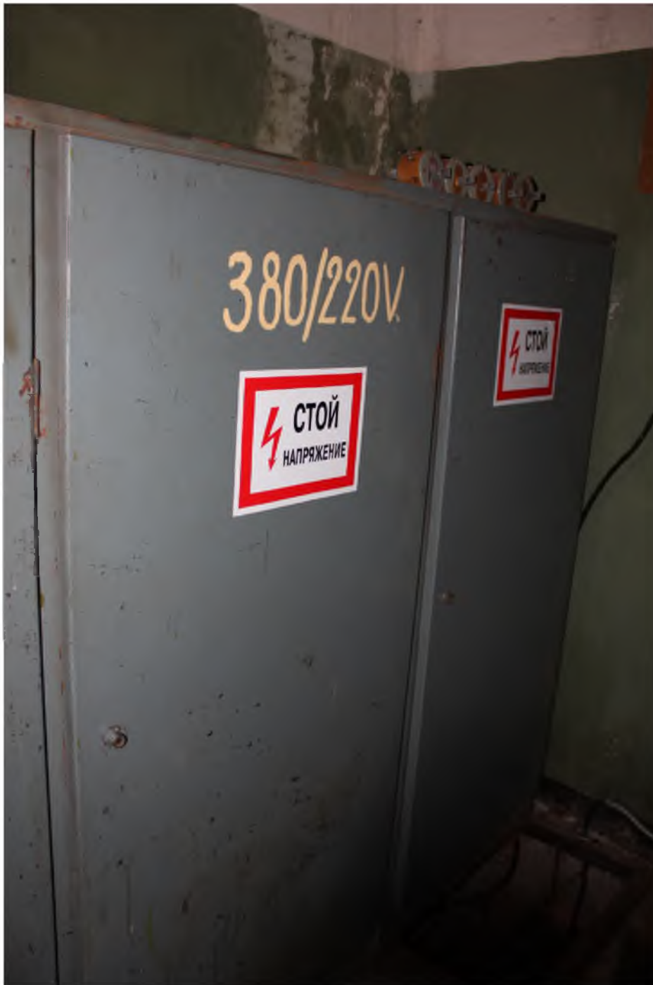
Фото 2.4 Шкафы ввода электроэнергии
