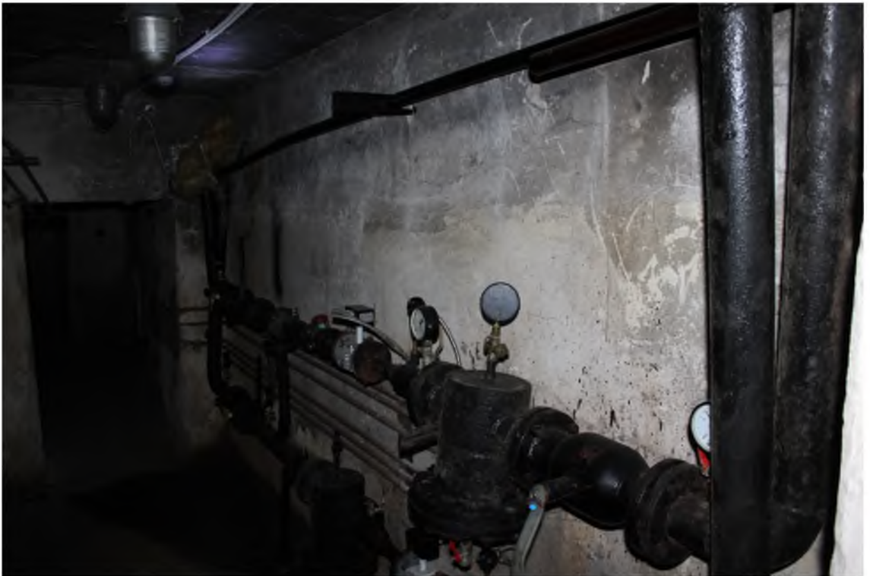
Фото 3.3 Общий вид теплового пункта
