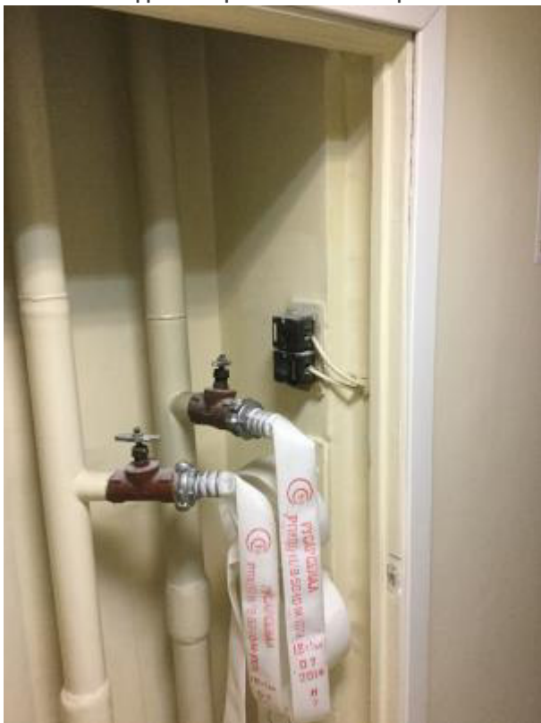
Фото 7.9 Вид коммуникаций объекта оценки Источник: данные заказчика
