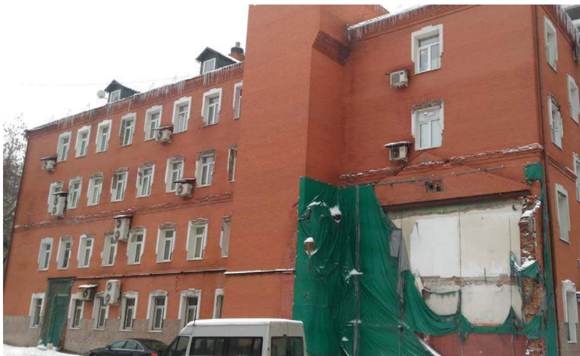
Рисунок 1. Фотографии обрушившихся, либо демонтированных частей здания
