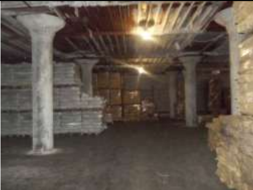
Рис. 9.26 Здание главный корпус (здание холодильника), пристройка к производственному участку, тамбур, 15 226 кв. м
