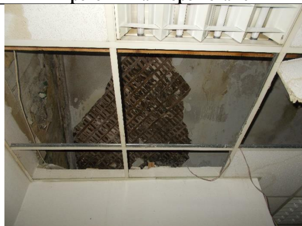
Разрушенные перекрытие и кровля
