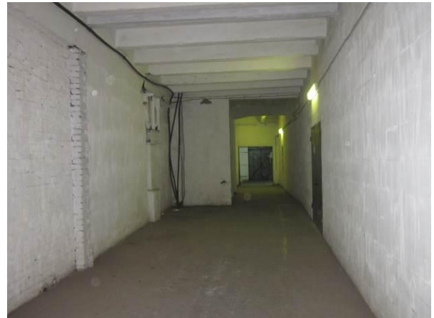
Фото 12. Выгороженная в результате перепланировки часть ч.п.2 и ч.п. 4 (с устройством дверного проема в корпус 71)
