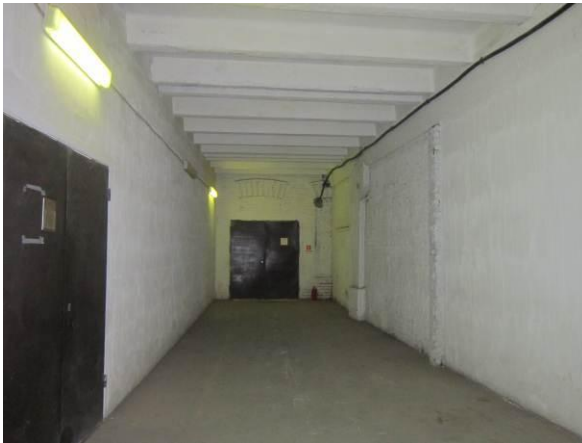
Фото 11. Выгороженная в результате перепланировки часть ч.п.2 и ч.п. 4 (с устройством дверного проема в корпус 75)
