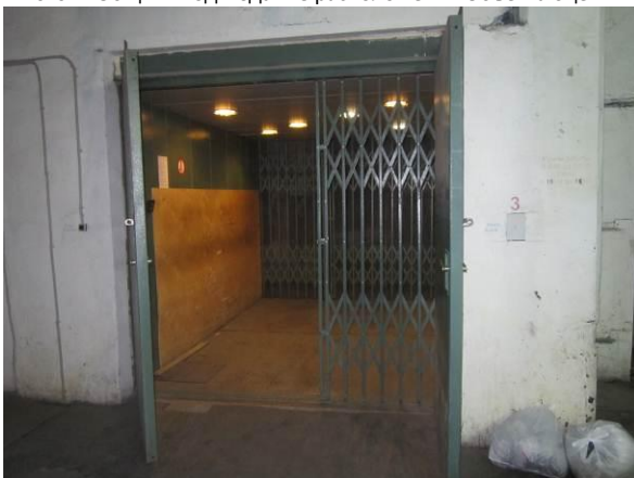
Фото 9. Лифт в здании расположения Объекта оценки
