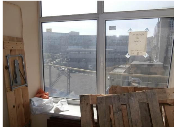
Фото 22. Типичное состояние оконных проемов Объекта оценки
