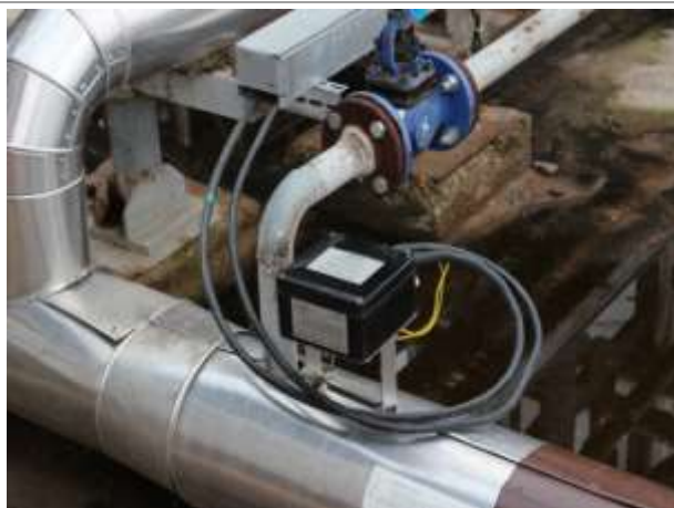
Фото 113. Инв. № 00001560, средства КИПиА с кабельными линиями установки ЭЛОУ
