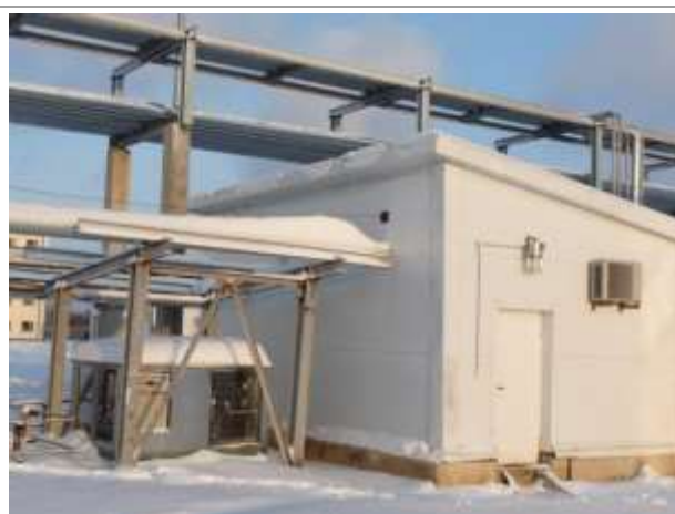
Фото 141. Инв. № 00001857, здание электрощитовой АСУР-ПБ-120
