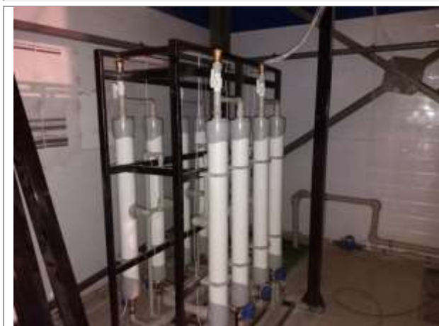
Фото 17. Технологическое оборудование водоподготовки питьевого водоснабжения
