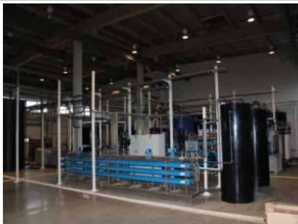
Фото 109. Инв. № 00001763, установка очистки сточных вод комплектная EUTUF-RAF
