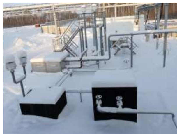
Фото 125. Инв. № 00001890, оборудование установки АСУР-ПБ-500
