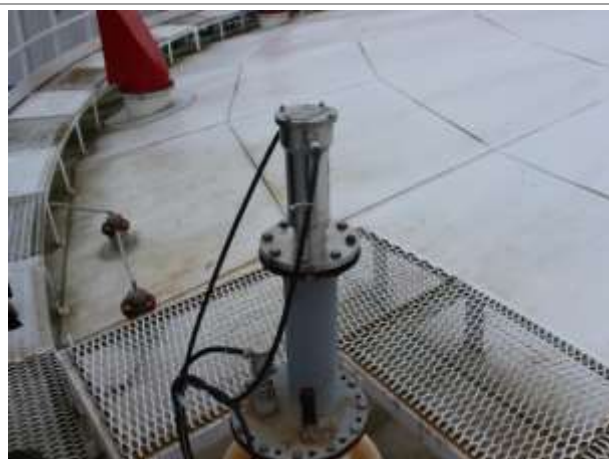
Фото 133. Инв. № 00001705, средства КИП и А с кабельными линиями внутрипарковые 1
