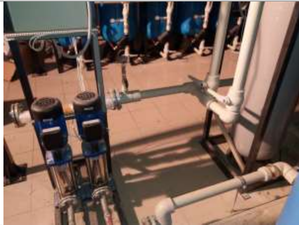
Фото 21. Технологическое оборудование водоподготовки питьевого водоснабжения
