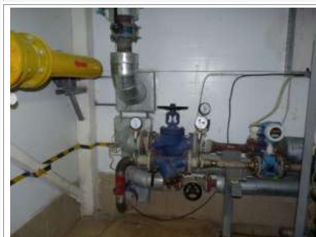
Фото 128. Инв. № 00001829, системы КИПиА энергоцентра
