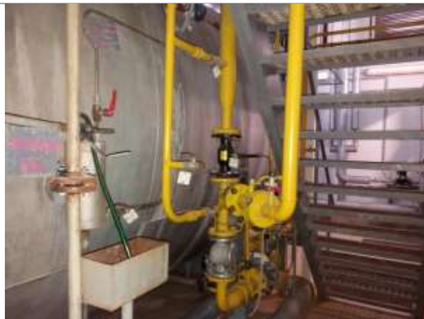
Фото 29. Трубопроводы газообразного топлива к котлам Энергоцентра
