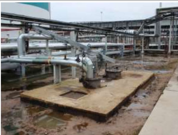
Фото 25. Инв. № 00001694, Подземная дренажная емкость подтоварной воды V=12,5 м3
