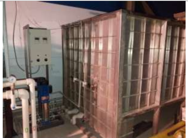
Фото 14. Технологическое оборудование водоподготовки питьевого водоснабжения
