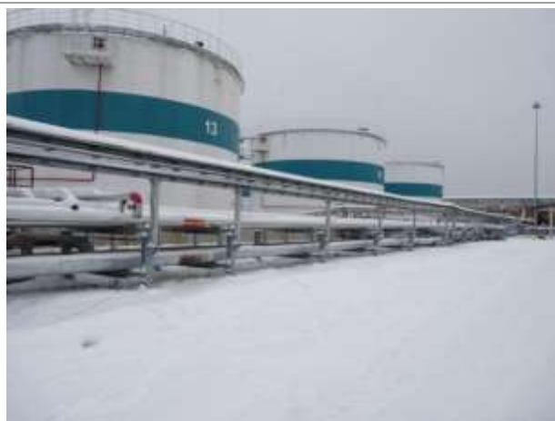
Фото 43. Инв. № 00001715, эстакады трубопроводов технологических внутрипарковых
