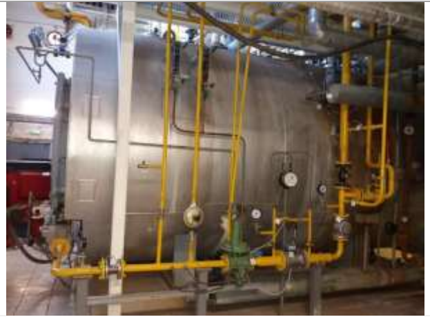
Фото 40. Трубопроводы газообразного топлива к котлам Энергоцентра
