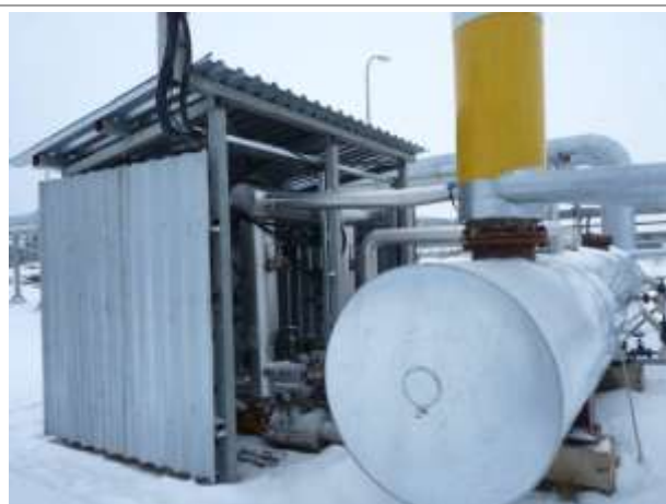
Фото 5. Инв. № 00001523, навес над электрооборудованием факельного хозяйства
