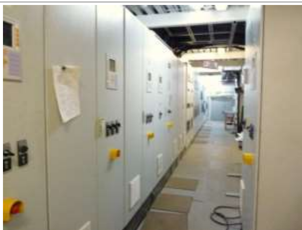
Фото 116. Инв. № 00001824, ГРЩ (главный распределительный щит)
