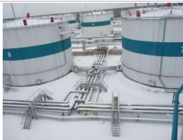
Фото 42. Инв. № 00001714, трубопровод технологический
