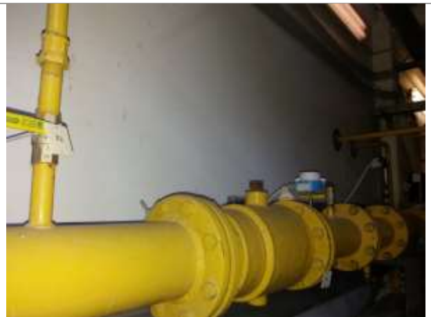
Фото 36. Трубопроводы газообразного топлива к котлам Энергоцентра
