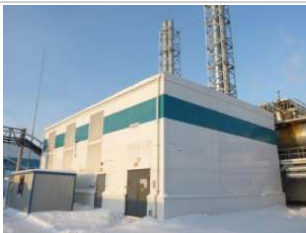
Фото 108. Комплекс ДГУ (Дизельно-генераторной установки)
