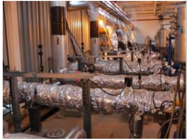
Фото 22. Инв. № 00001685, трубопроводы технологические насосной ГЖ №2
