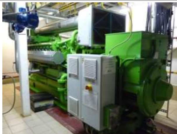
Фото 115. Инв. № 00001820, газопоршневой агрегат JMS 320
