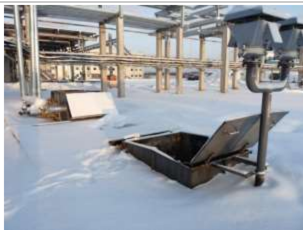
Фото 30. Инв. № 00001699, Подземный резервуар аварийных проливов из автоцистерн V=60м 3
