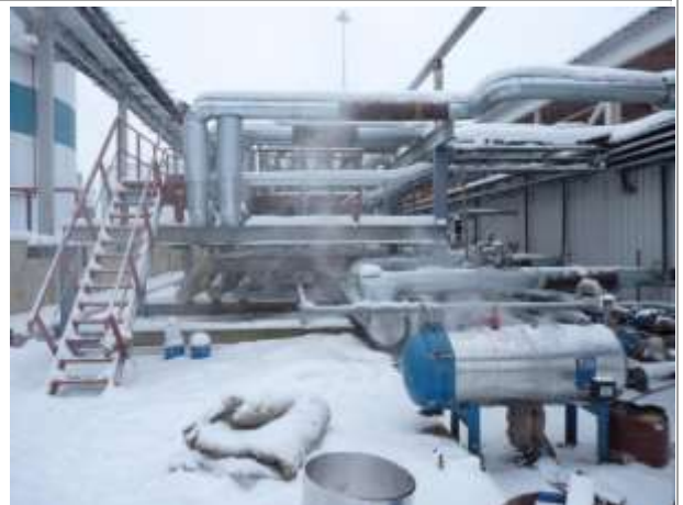
Фото 24. Инв. № 00001692, Площадка управления задвижками насосная № 1 ЛВЖ
