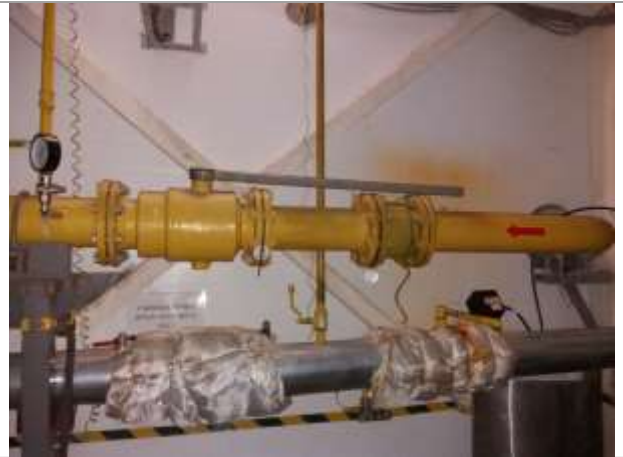
Фото 34. Трубопроводы газообразного топлива к котлам Энергоцентра
