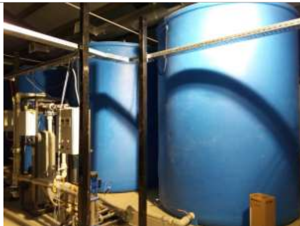
Фото 11. Технологическое оборудование водоподготовки питьевого водоснабжения
