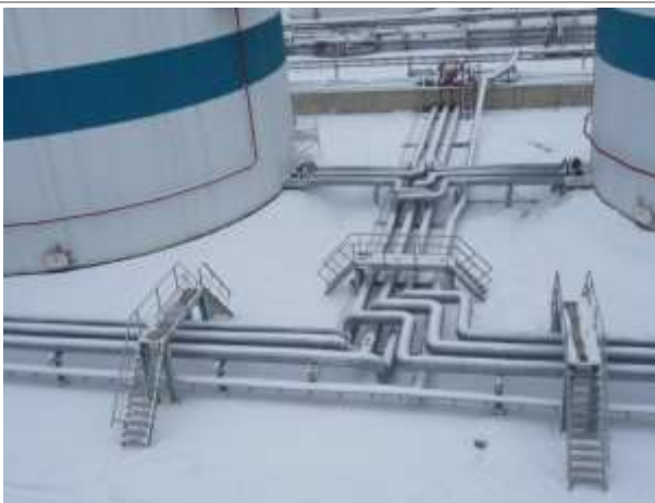
Фото 35. Инв. № 00001706, трубопровод технологический РП№1
