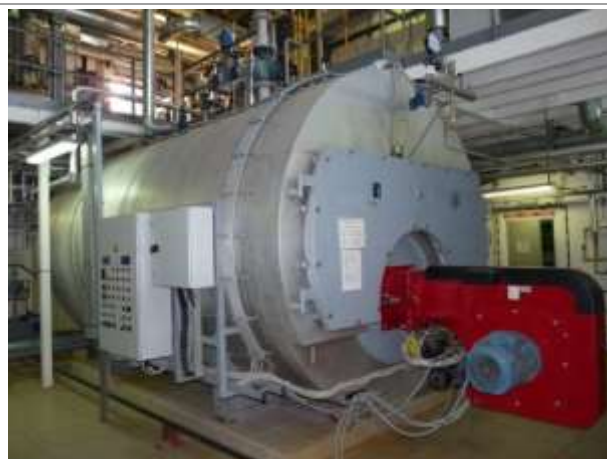
Фото 119. Инв. № 00001827, паровой котел ТТК-150 №2
