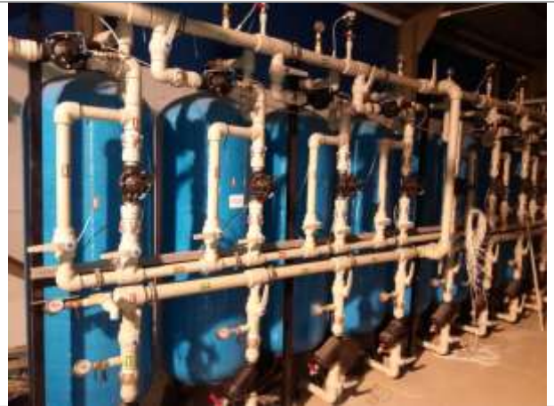
Фото 10. Технологическое оборудование водоподготовки питьевого водоснабжения
