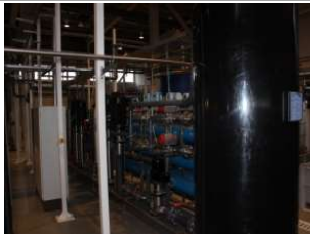
Фото 110. Инв. № 00001763, установка очистки сточных вод комплектная EUTUF-RAF
