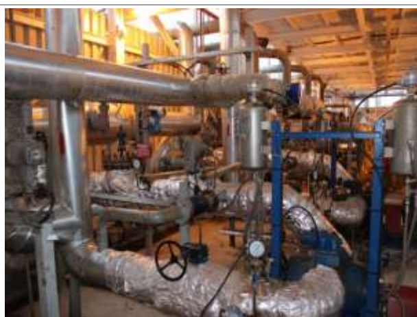
Фото 19. Инв. № 00001672, трубопроводы технологические насосной ЛВЖ №1
