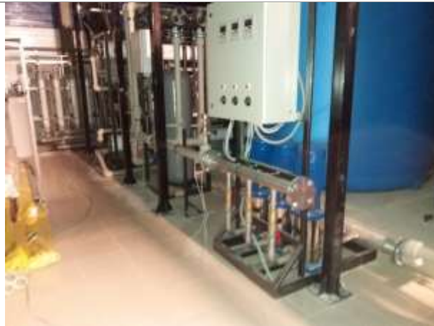
Фото 13. Технологическое оборудование водоподготовки питьевого водоснабжения
