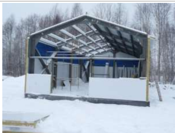
Фото 66. Планируется к вводу в эксплуатацию в декабре 2012, здания скважин питьевого водопровода
