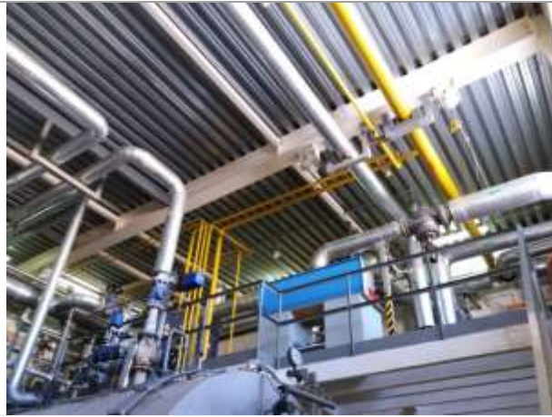
Фото 39. Трубопроводы газообразного топлива к котлам Энергоцентра
