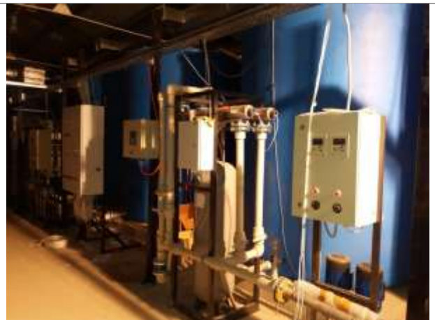
Фото 12. Технологическое оборудование водоподготовки питьевого водоснабжения
