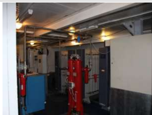
Фото 121. Инв. № 00001444, Азотно-воздушная компрессорная станция (с учетом установленного оборудования)
