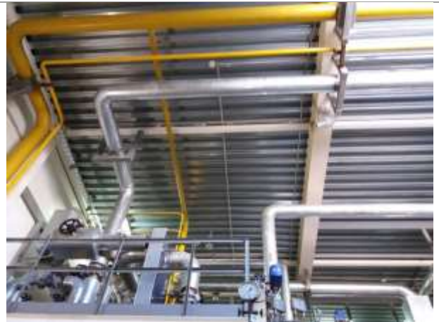
Фото 38. Трубопроводы газообразного топлива к котлам Энергоцентра
