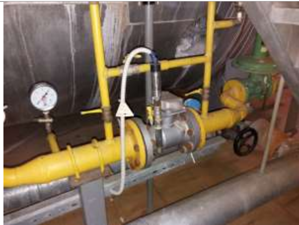
Фото 31. Трубопроводы газообразного топлива к котлам Энергоцентра
