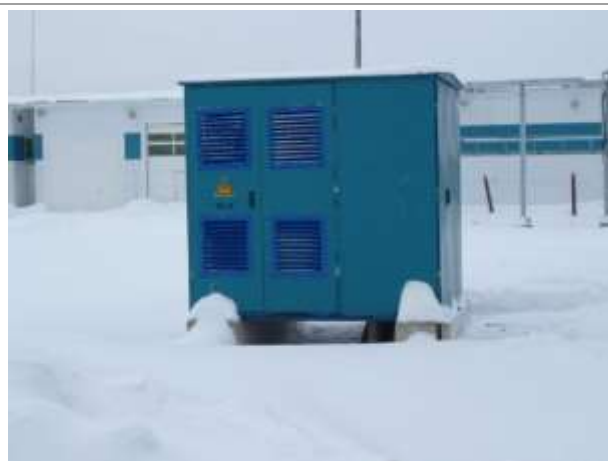
Фото 76. Планируется к вводу в эксплуатацию в декабре 2012, КТП-Т 1000
