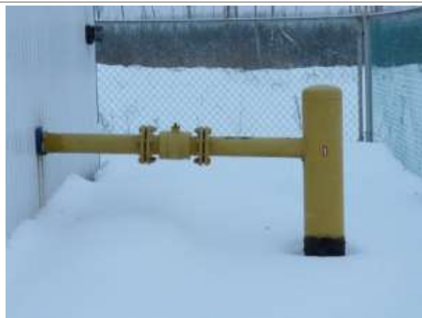
Фото 98. Инв. № 00001411, газопровод подводящий
