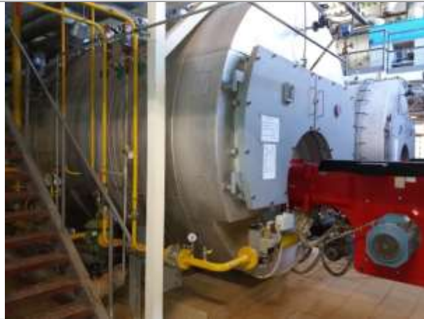
Фото 27. Трубопроводы газообразного топлива к котлам Энергоцентра
