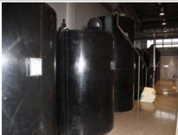
Фото 111. Инв. № 00001763, установка очистки сточных вод комплектная EUTUF-RAF
