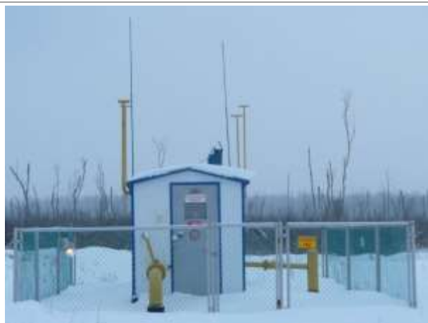
Фото 97. Пункт газораспределительный блочный (ПГБ)
