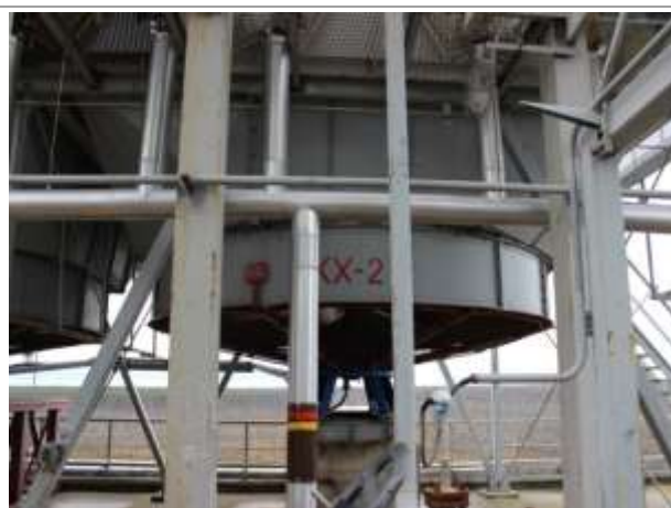
Фото 137. Инв. № 00001532, аппарат воздушного охлаждения (АВО) с фундаментом Кх-2
