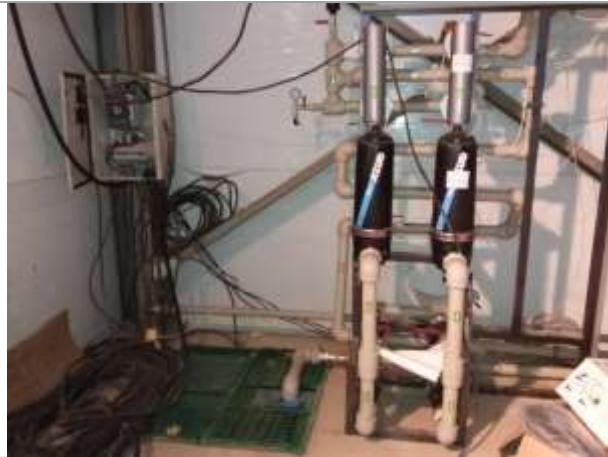
Фото 9. Технологическое оборудование водоподготовки питьевого водоснабжения
