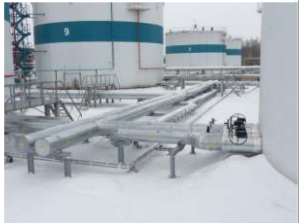
Фото 50. Инв. № 00001723, трубопровод технологический 3
