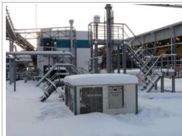
Фото 126. Инв. № 00001890, оборудование установки АСУР-ПБ-500
