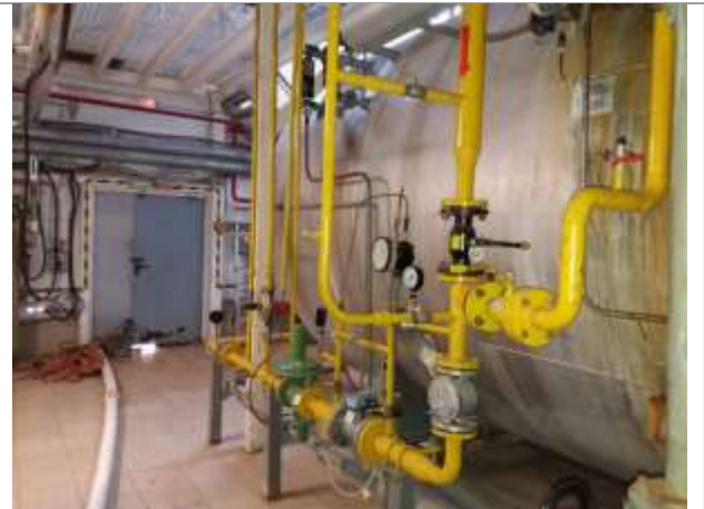
Фото 32. Трубопроводы газообразного топлива к котлам Энергоцентра
