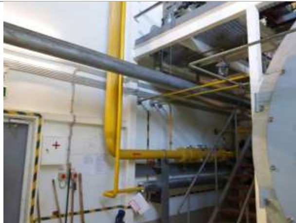
Фото 37. Трубопроводы газообразного топлива к котлам Энергоцентра
