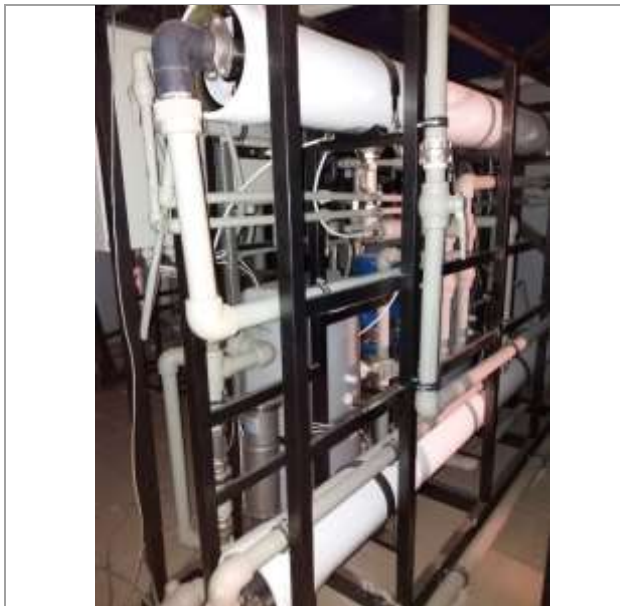
Фото 19. Технологическое оборудование водоподготовки питьевого водоснабжения
