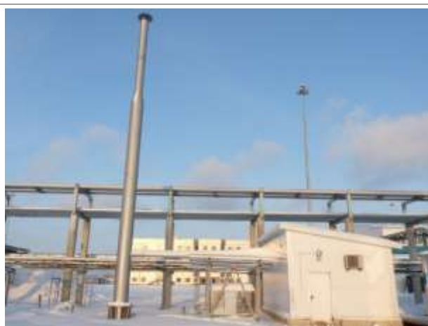
Фото 140. Инв. № 00001857, здание электрощитовой АСУР-ПБ-120
