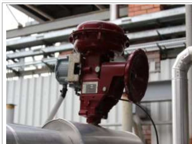
Фото 130. Инв. № 00001530, системы КИПиА печи
