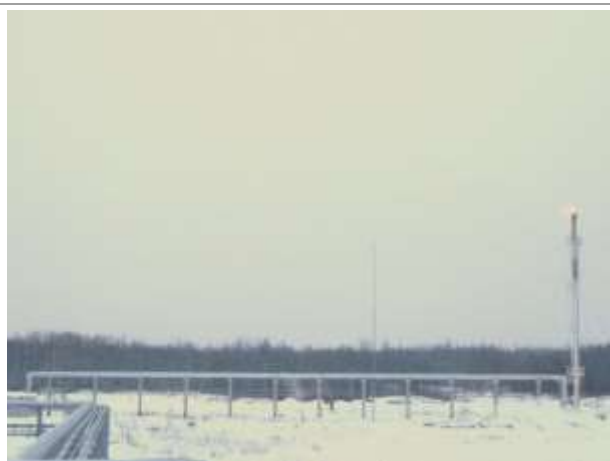
Фото 7. Инв. № 00001528, факельная установка
