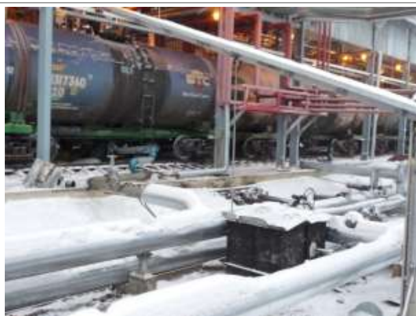
Фото 29. Инв. № 00001698, резервуар аварийного пролива №25.4 ГЖ
