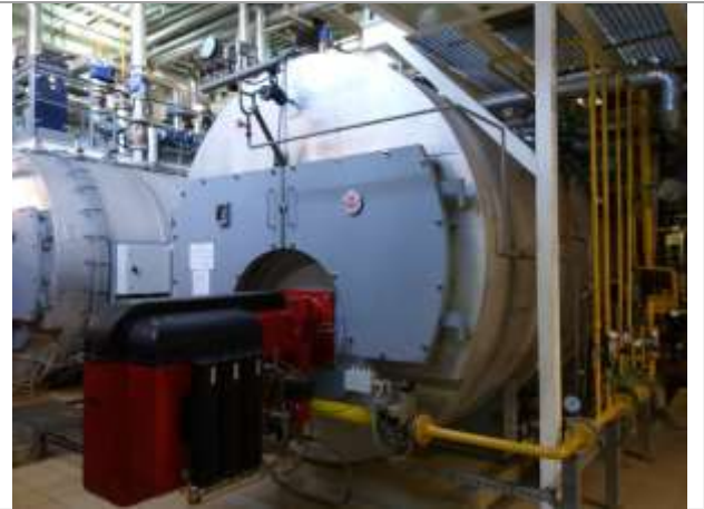
Фото 22. Трубопроводы газообразного топлива к котлам Энергоцентра
