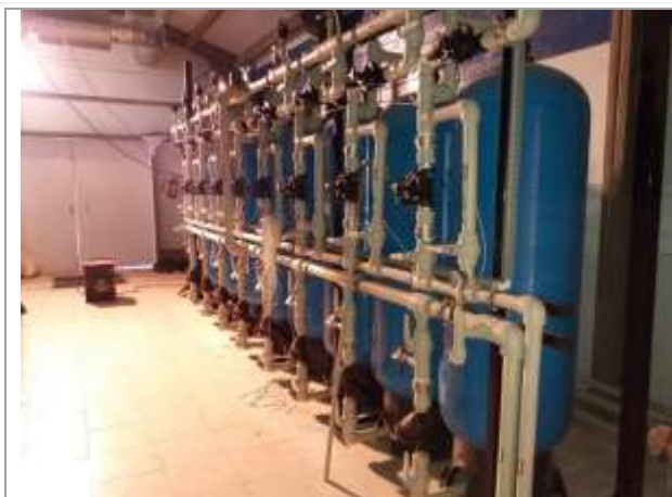
Фото 15. Технологическое оборудование водоподготовки питьевого водоснабжения
