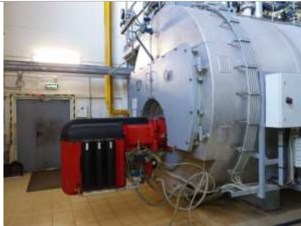
Фото 25. Трубопроводы газообразного топлива к котлам Энергоцентра
