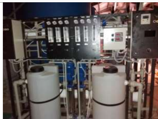
Фото 18. Технологическое оборудование водоподготовки питьевого водоснабжения
