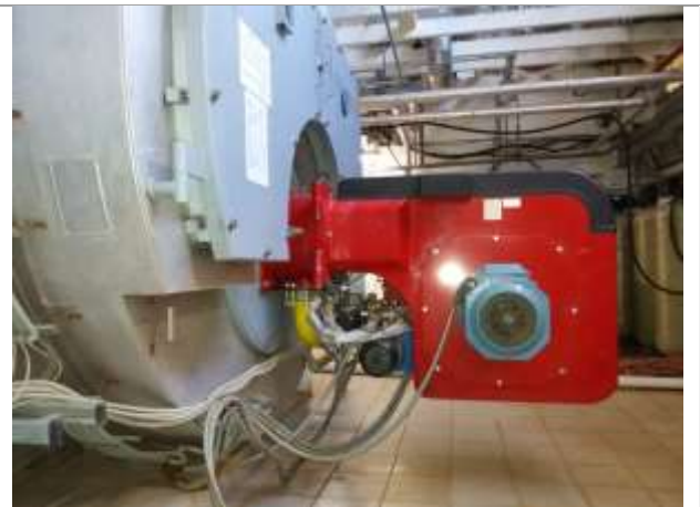
Фото 24. Трубопроводы газообразного топлива к котлам Энергоцентра
