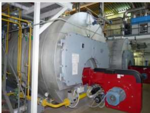
Фото 118. Инв. № 00001826, паровой котел ТТК-150 №1
