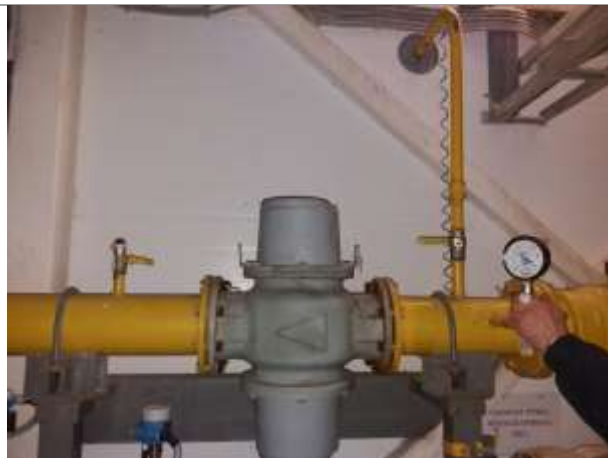
Фото 35. Трубопроводы газообразного топлива к котлам Энергоцентра
