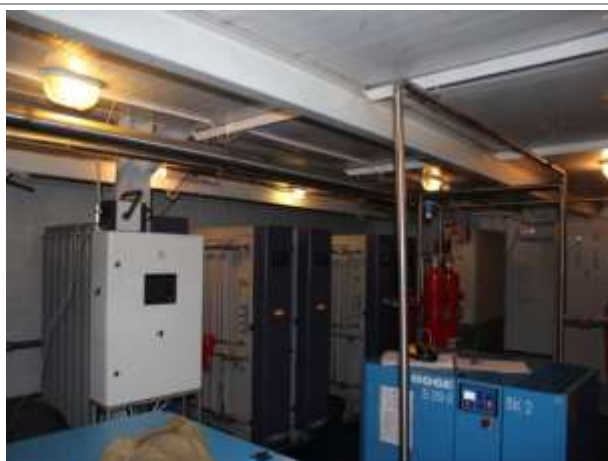
Фото 120. Инв. № 00001444 , Азотно-воздушная компрессорная станция (с учетом установленного оборудования)
