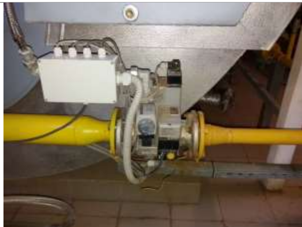
Фото 23. Трубопроводы газообразного топлива к котлам Энергоцентра
