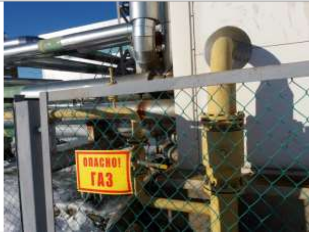
Фото 33. Трубопроводы газообразного топлива к котлам Энергоцентра
