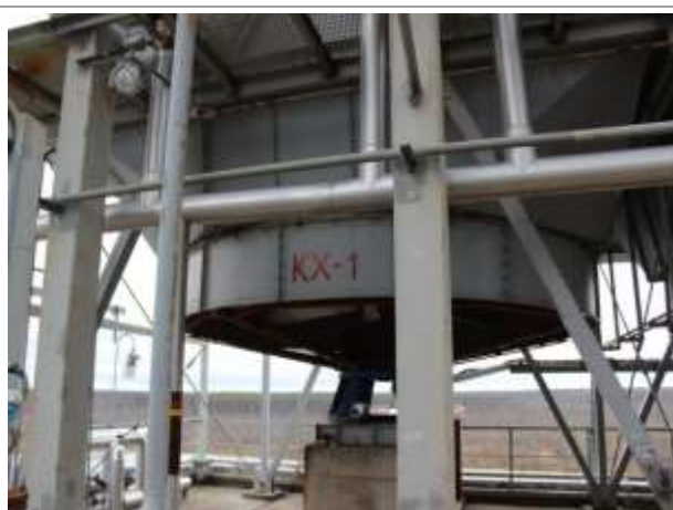
Фото 136. Инв. № 00001531, аппарат воздушного охлаждения (АВО) с фундаментом Кх-1
