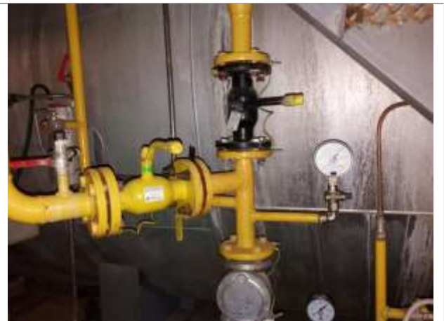
Фото 30. Трубопроводы газообразного топлива к котлам Энергоцентра
