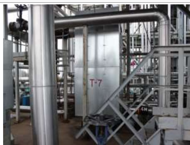
Фото 127. Инв. № 00001549, теплообменник Т-7
