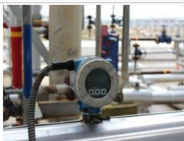
Фото 129. Инв. № 00001530, системы КИПиА печи
