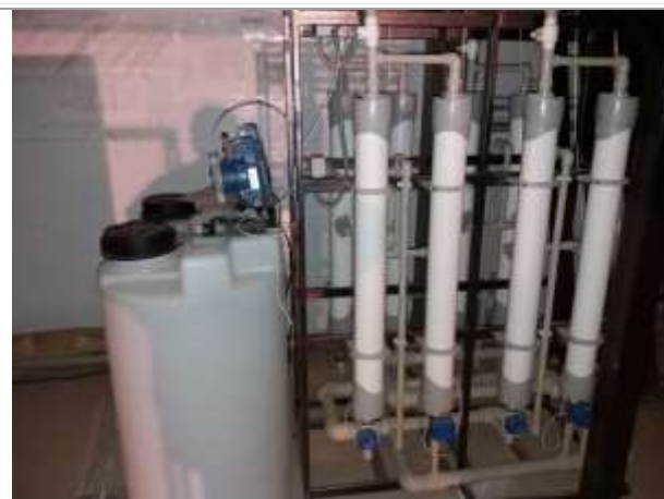
Фото 16. Технологическое оборудование водоподготовки питьевого водоснабжения
