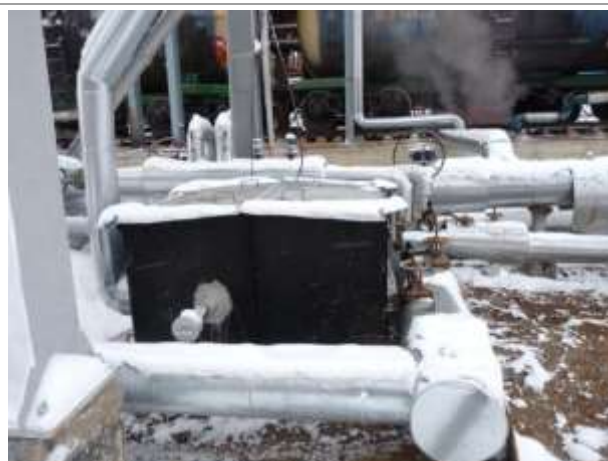
Фото 28. Инв. № 00001697, резервуар аварийного пролива №25.3 ГЖ
