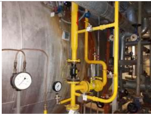
Фото 41. Трубопроводы газообразного топлива к котлам Энергоцентра
