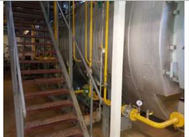
Фото 28. Трубопроводы газообразного топлива к котлам Энергоцентра
