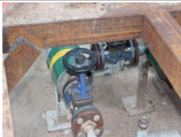
Фото 114. Инв. № 00001560, средства КИПиА с кабельными линиями установки ЭЛОУ
