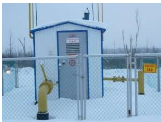
Фото 99. Инв. № 00001414, ограждение газопровода
