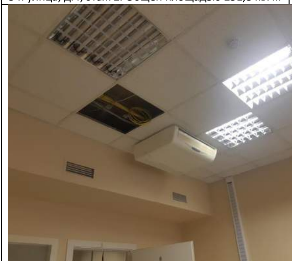
107076 г. Москва, р-н Преображенское, Бухвостова 3-я улица, д.4, этаж 2. Общей площадью 251,8 кв. м
