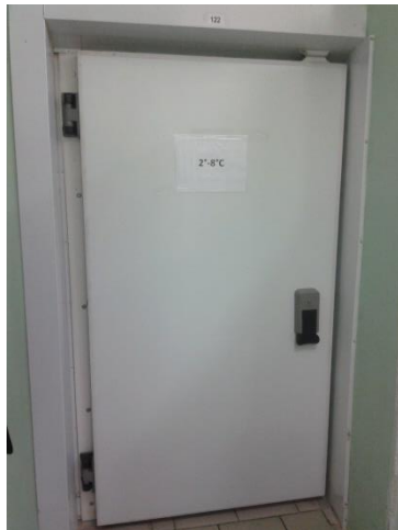
Дверь Холодильной камеры ХК-2
