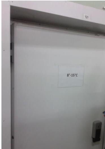
Дверь Холодильной камеры ХК-1
