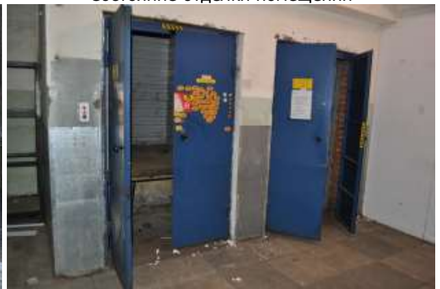
Состояние отделки помещений
