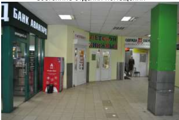
Состояние отделки помещений
