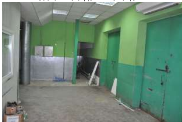
Состояние отделки помещений
