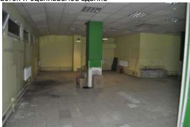
Состояние отделки помещений
