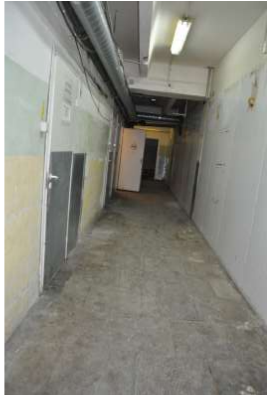
Состояние отделки помещений
