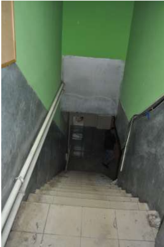
Состояние отделки помещений
