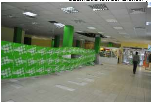
Состояние отделки помещений
