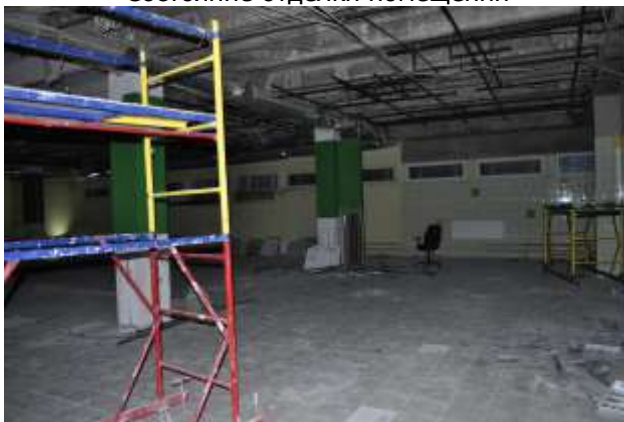
Состояние отделки помещений
