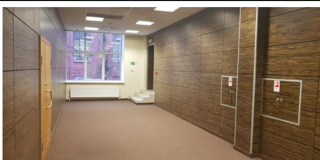
Фото 5. Состояние внутренних помещений 2-го этажа
