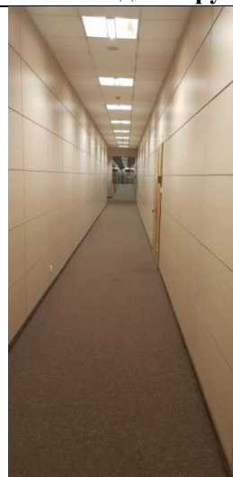
Фото 4. Состояние внутренних помещений 2-го этажа
