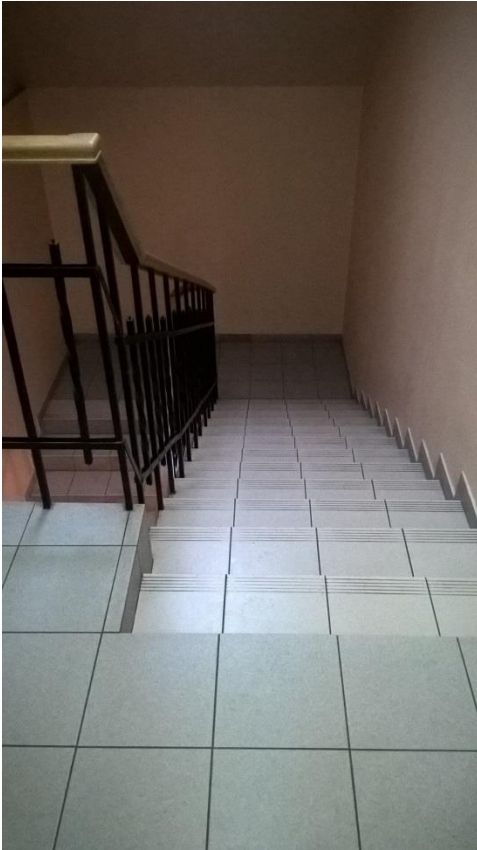
Фото 4. Состояние мест общего пользования в здании
