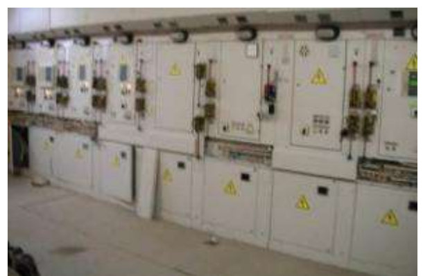
Электрическая часть собственных нужд 0,4 КВ
