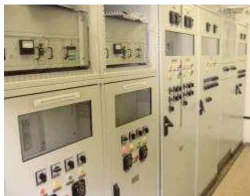
Электрическая часть, узел учета
