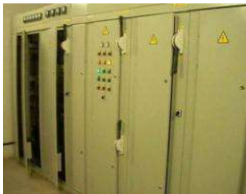
Электрическая часть, 0,4/10 КВ
