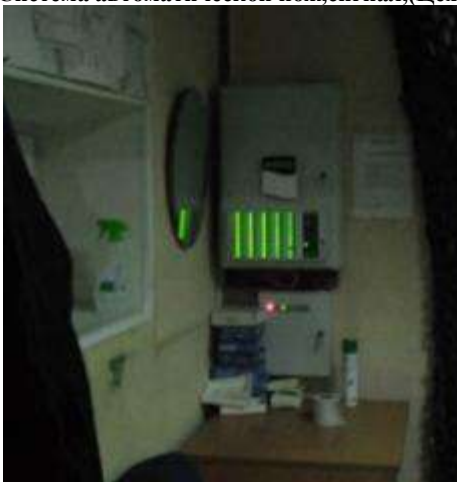
Ивв.400077, Система автоматической пож,сигнал, в Конторе звер,
