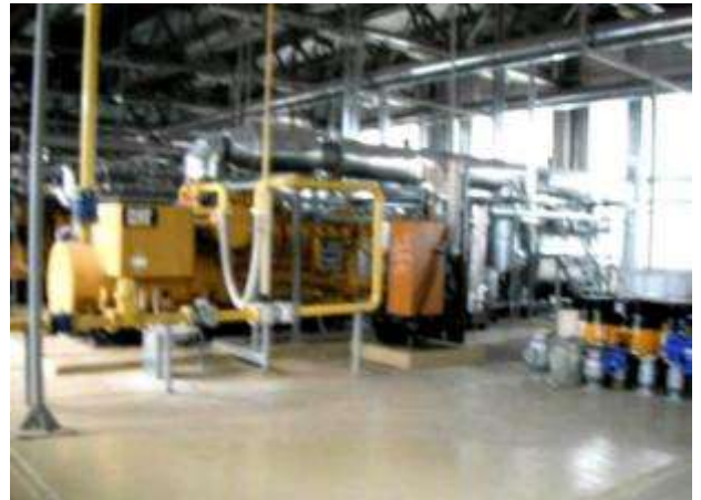
Машинный зал, теплоэлектрический участок, газовые мотор-генераторы с котлами утилизаторами
