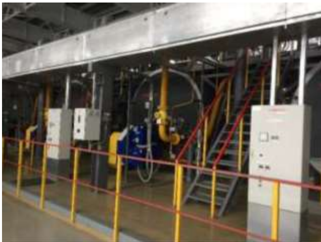
Рисунок 7.13. Котел Vissmann VITOMAX 200HW (I пусковой комплекс ГТЭС «Щербинка»)
