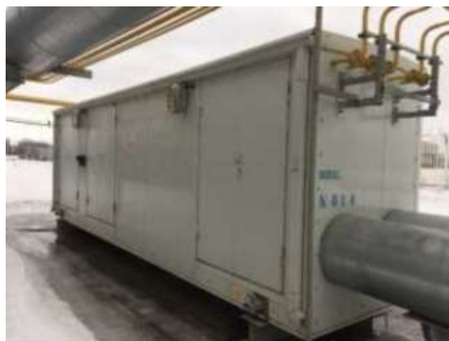
Рисунок 7.12. Газорегуляторный пункт ГРПШ-5900 (I пусковой комплекс ГТЭС «Щербинка»)
