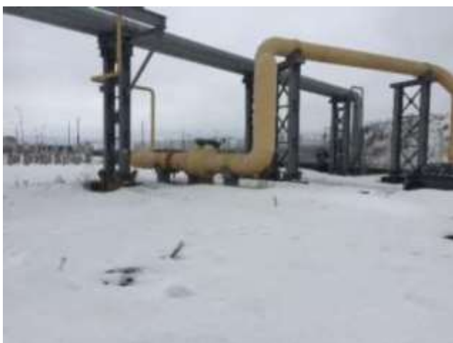
Рисунок 7.11. Газопровод и теплотрасса на эстакаде (I пусковой комплекс ГТЭС «Щербинка»)
