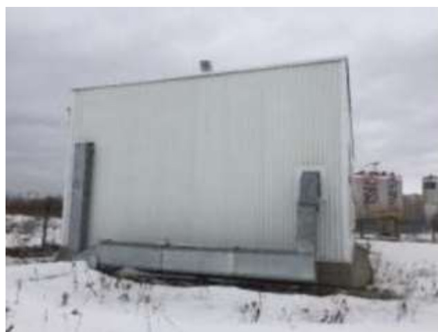
Рисунок 7.8. Насосная станция пожаротушения (I пусковой комплекс ГТЭС «Щербинка»)
