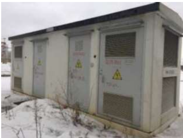
Рисунок 7.7. Трансформаторная подстанция (I пусковой комплекс ГТЭС «Щербинка»)
