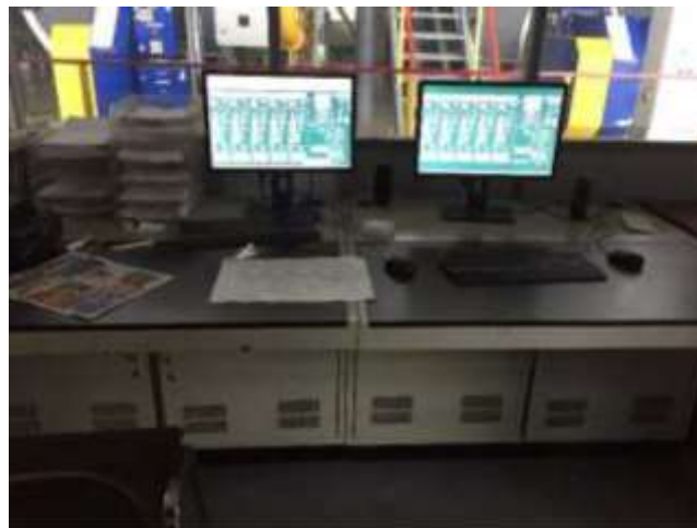
Рисунок 7.16. Пультавая секция (I пусковой комплекс ГТЭС «Щербинка»)
