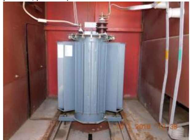
Фото 7.64. Трансформатор ТМГ 11 160/10/0,4 Y/Z.
