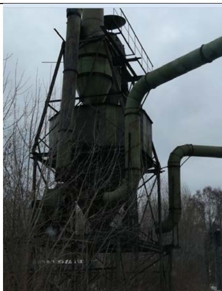
ФОТО № 10. Пневмотранспорт для подачи древесных отходов, инв. № 3060
