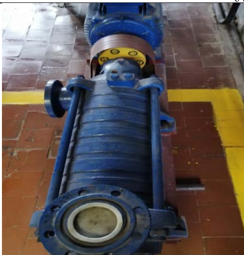
ФОТО № 7. Насос ЦНС(Г) 38-176 с/дв 30/3000/лапы/ИР54/Д48 (ПНСК), инв. 000000149
