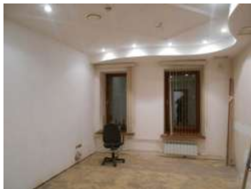
Фото 6.10 Нежилое здание г. Москва, пер. Спиридоньевский, д. 17, стр. 1, 3 этаж
