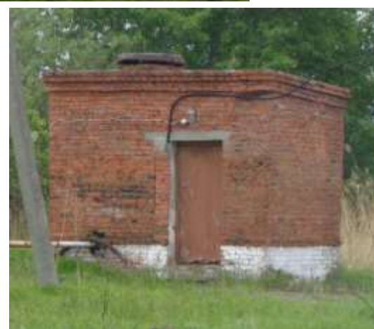
4 насосные станции имеют идентичную конструкцию
