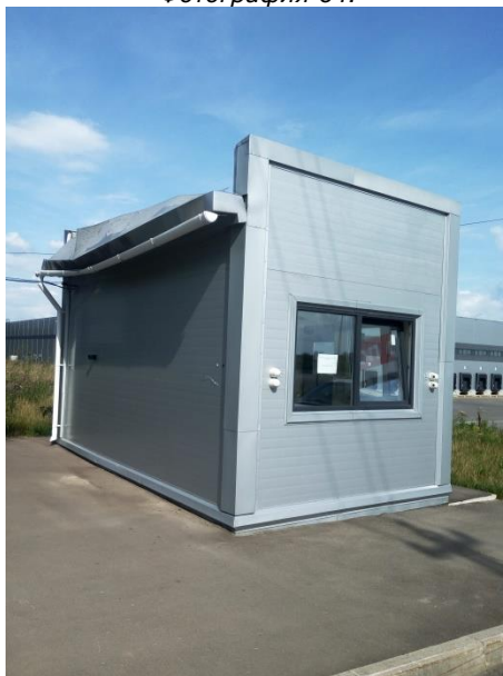
Трансформаторная подстанция (состоящая из 2 КТПБ по 1250 кВА каждый) Фотография 65.
