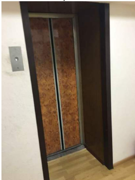
Фото 7. Лифт на 5-й этаж
