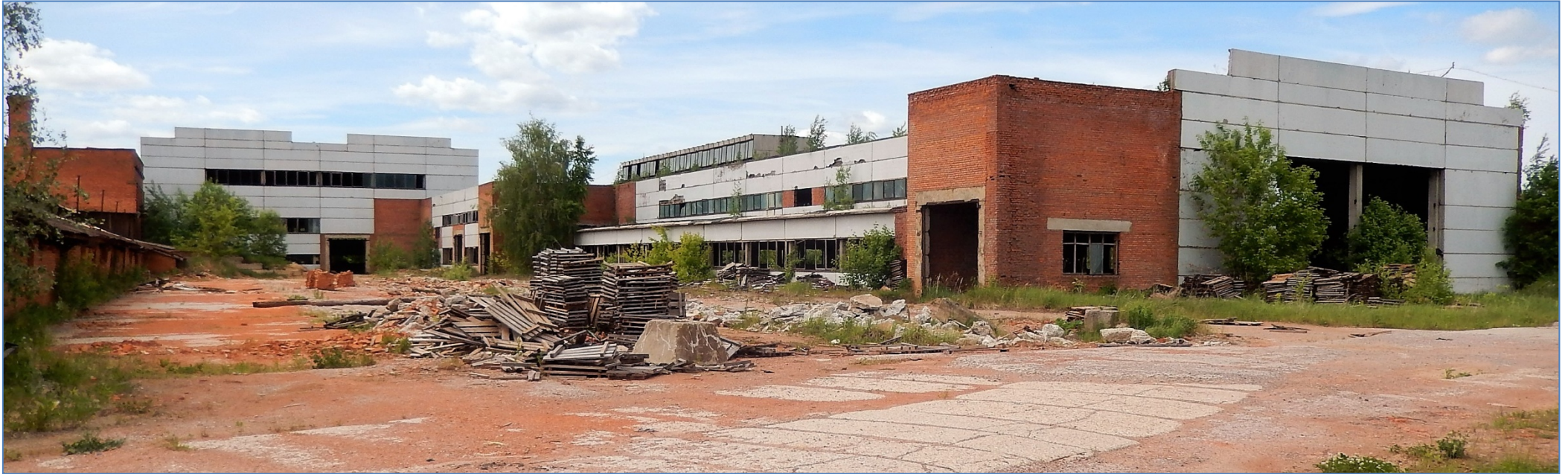
Панорамный вид на один из внутренних дворов ОАО «ГКЗ» и на «Объект незавершенного строительства (Печной корпус) 7 774,90 кв.м.», с расширением кадастрового номера «280».
